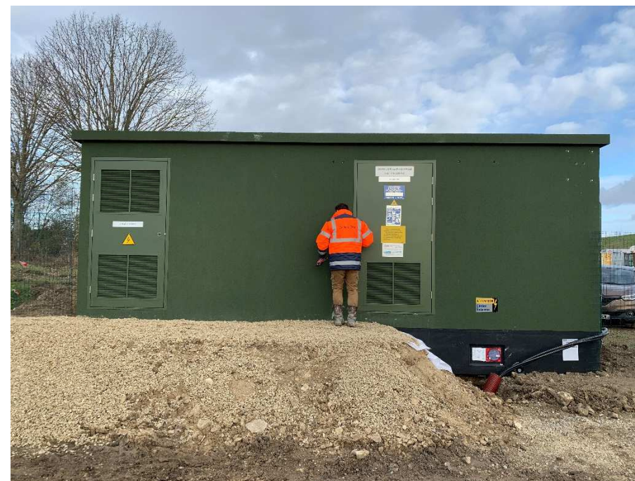
Illustration 6 : Exemple de poste de livraison
