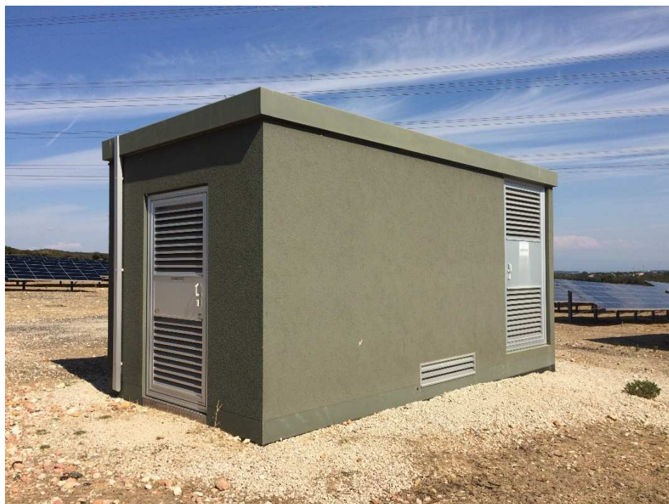
Illustration 4 : Exemple de poste de transformation « indoor »
