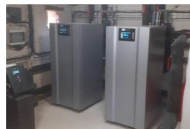
Figure 87 Chaudière biomasse du Château de Puymartreau
