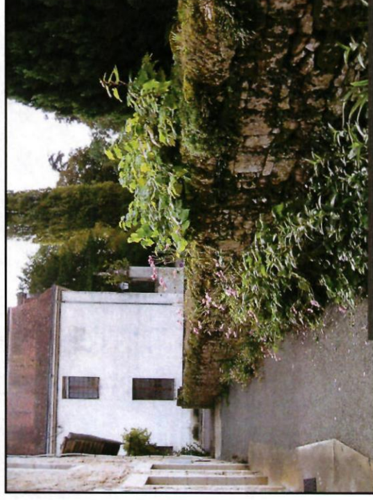
Muret en pierres, BARRIBREFFECTURE
